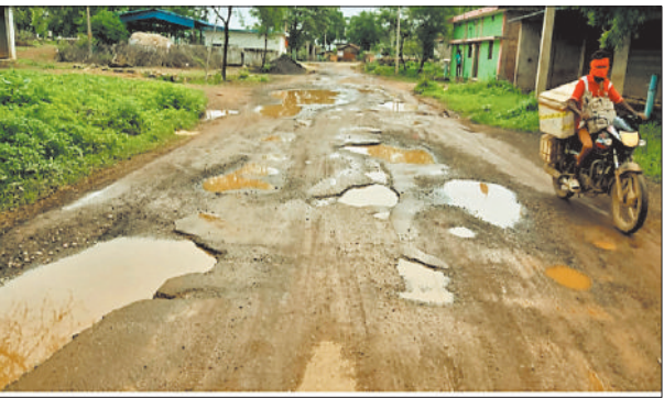
अर्जुनी की जर्जर सड़क मार्ग
